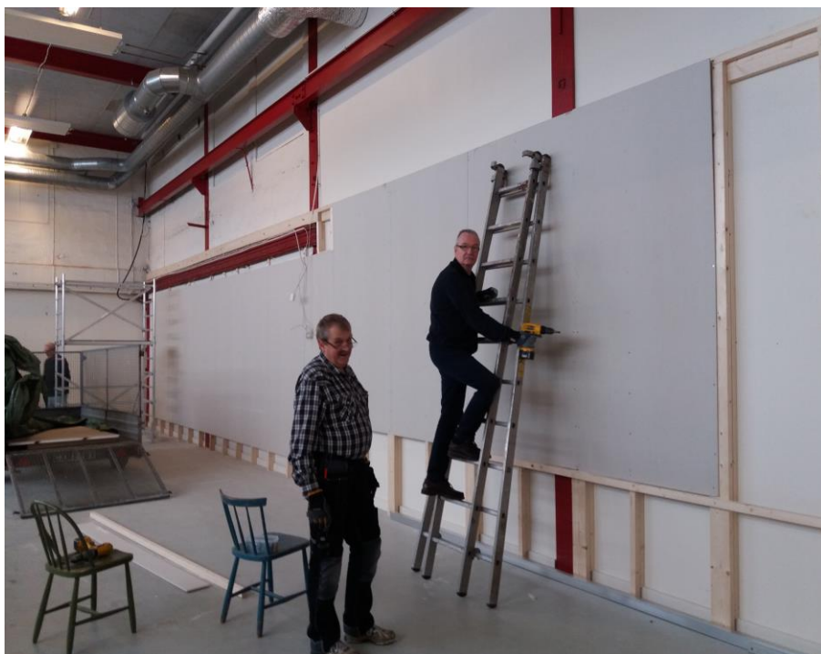
Första åtgärden var att montera reglar och gips på bakväggen. Reglarna var också det som entresolplanet skulle vila på. Här är Anders och Kjell montörer.
